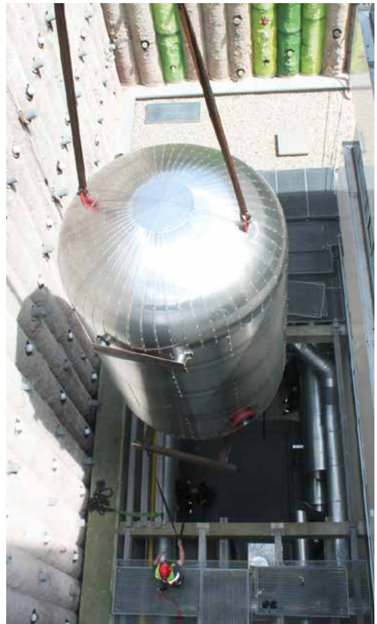
Mit dem zweiten Pufferspeicher war die Energiezentrale im Mai 2017 komplett
